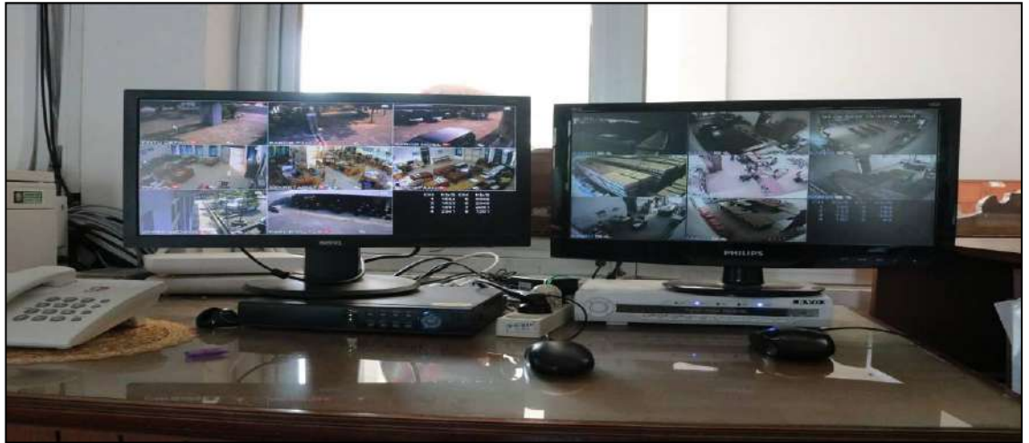
DPMPT Kab. Bantul, Foto Dok. 9 : Monitor Pengendali Perangkat CCTV;
